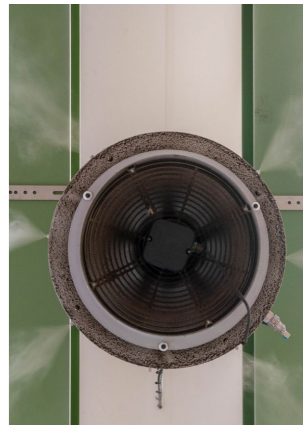
◀ Topmoderne ventilation- og befugtningsanlæg bidrager til energioptimering og et bedre arbejdsmiljø.
