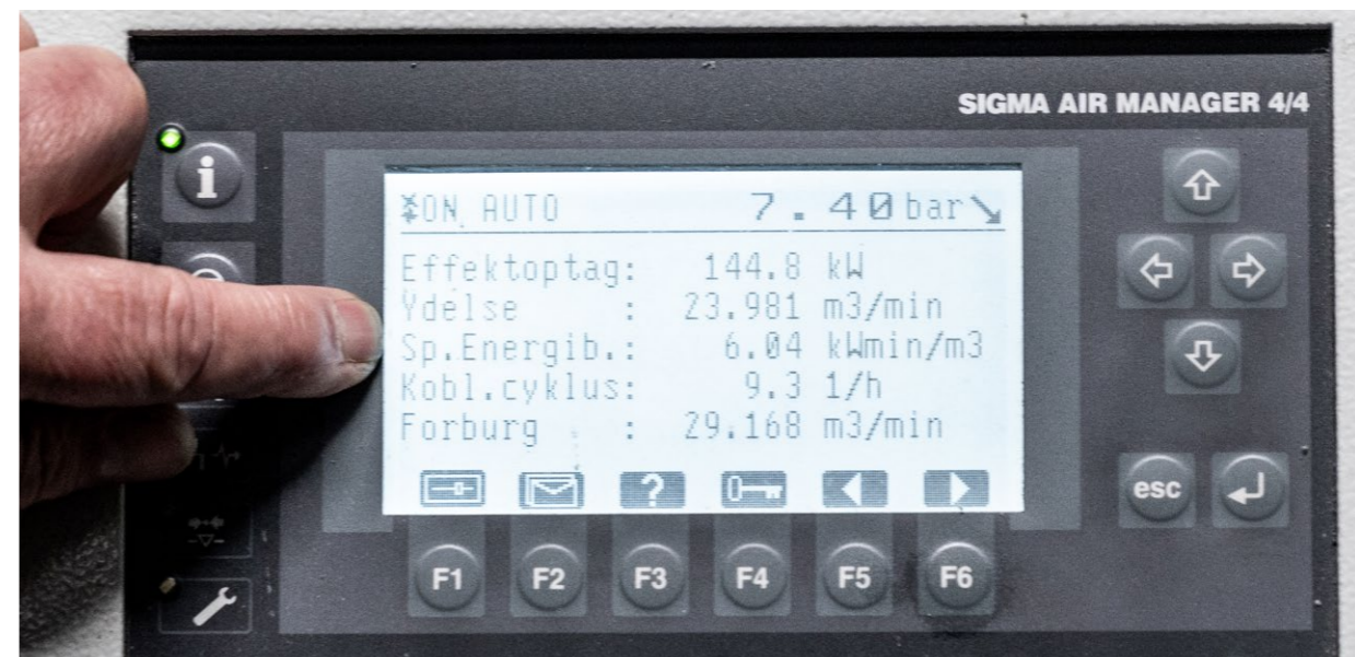
▲ Frekvensstyring sikrer, at Schelas forbrug er konstant og lavt. De 6.05 kWmin/m 3 viser, hvor stort elforbruget er til at genere den på det tidspunkt givne mængde trykluft.
