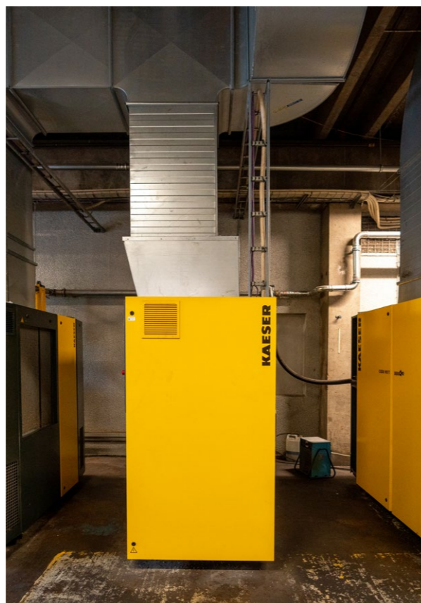
▲ Et helt nyt anlæg til trykluft har intelligent styring og leverer præcis den mængde trykluft, der er behov for. Det giver mindre energiforbrug til kompressorer.
